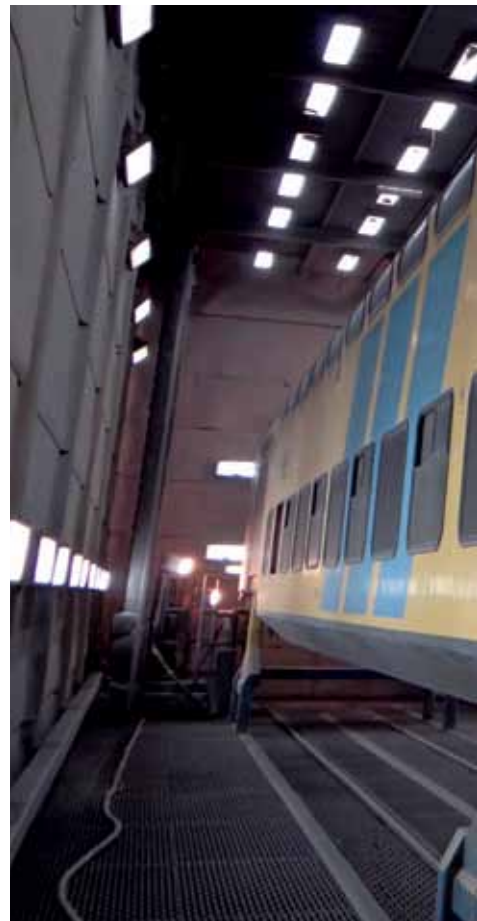
De straalcabine is uitgevoerd met een diepe gritkelder en bodemaftzuiging.
